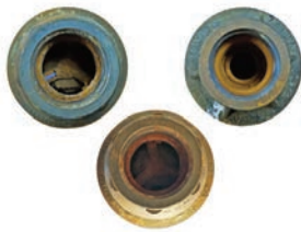
الداخل والخارج لمنظمات الضغط المتآكلة
